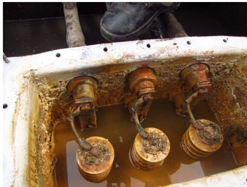
состояние коробки, герметичность которой нарушена в эксплуатации
