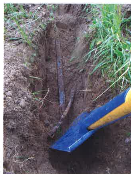
Рис. 4. Разрушение сварного соединения в узле присоединения заземляющего спуска к ЗУ на шинной опоре 110 кВ
