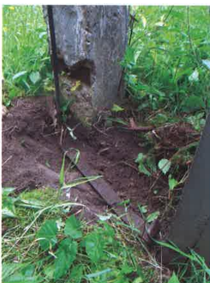
Рис. 3. Разрушение сварного соединения на шинном разъединителе ТСН-1
