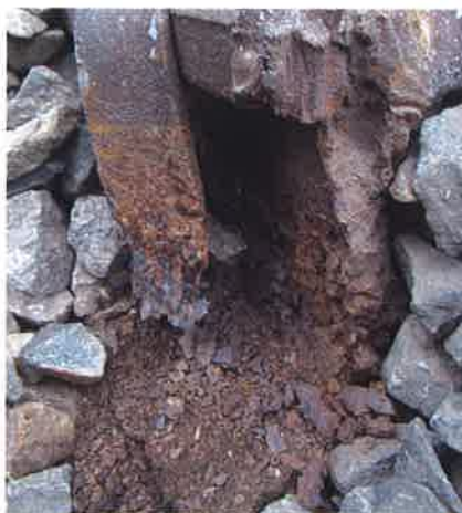
Рис. 2. Разрушение в переходной зоне заземляющего спуска рельса силового трансформатора
