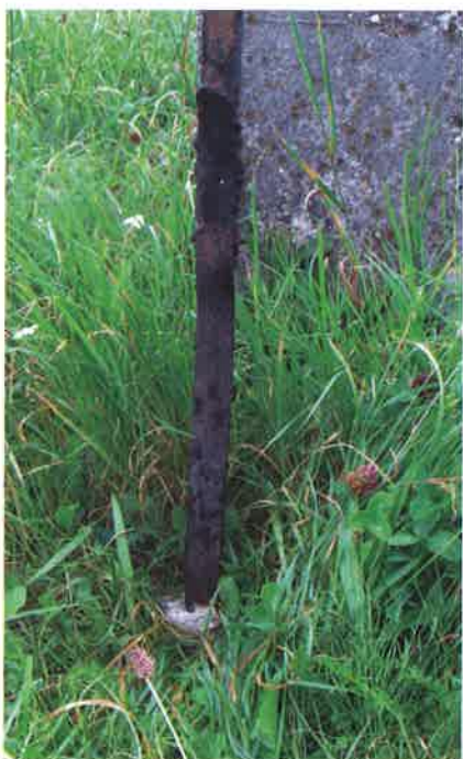
Рис. 1. Разрушение заземляющего спуска в переходной зоне на секционном разъединителе ПС 110 кВ
